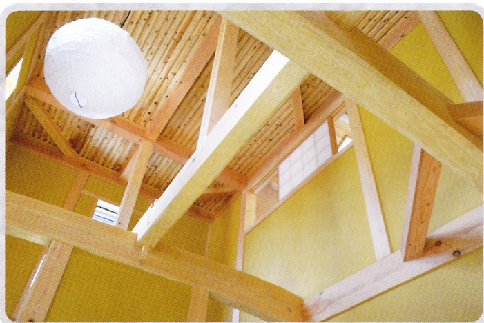
●玄関ホールは木材を現して組み上げた開放感のある吹き抜けになっています。
